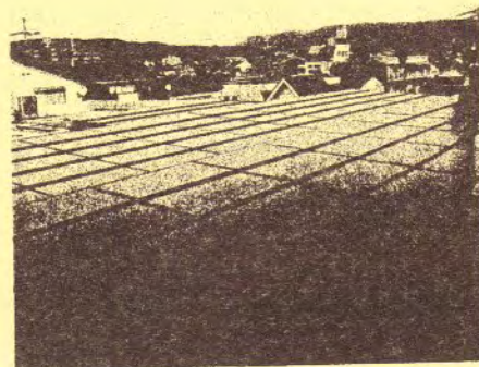
太陽光パネル
